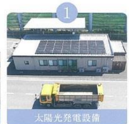
太陽光発電設備
