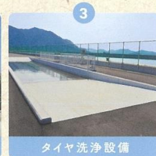
タイヤ洗浄設備
