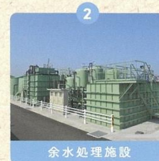
余水処理施設
