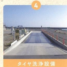
タイヤ洗浄設備
